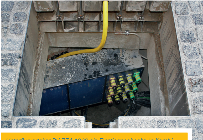
Unterflurverteiler PIAZZA 1000 als Einstiegsschacht, in Kombination mit Vollgummi-Verteiler und Powersafe-Steckverbindungen
